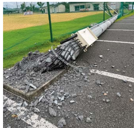
益城町町民グラウンドのナイター照明が倒壊
