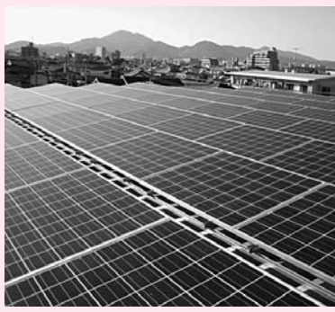
水前寺幼稚園園舎に設置された太陽光発電システム
